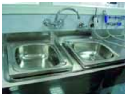
Figura 96 – Acople para el fregadero (reduce la profundidad efectiva del mismo).
